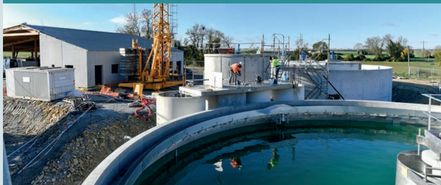
Station d'épuration de Mauzé-sur-le-Mignon © Darré
